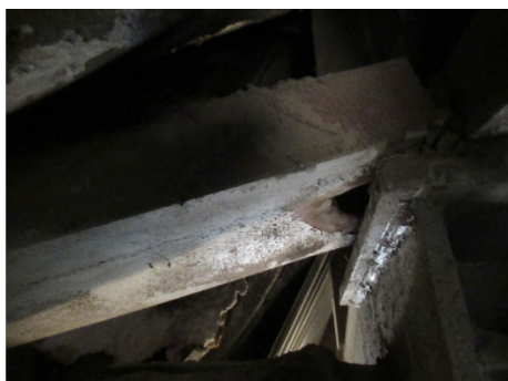
图 4 灰斗与其连接节点部位焊缝未焊满
