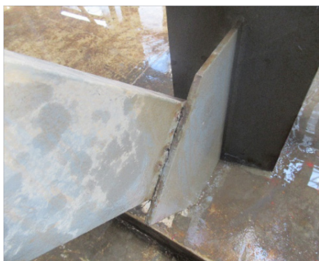
图 3 柱脚节点处焊缝未焊满
