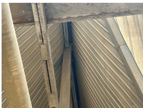
图 5 柱顶支座滑移过大
