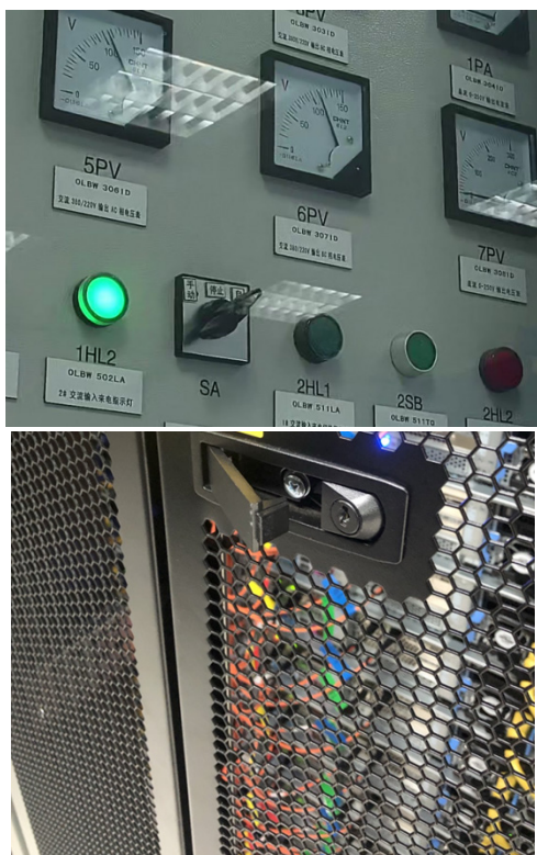
图1 实际拍摄中常见的重影反光以及机柜网孔的阻挡问题
