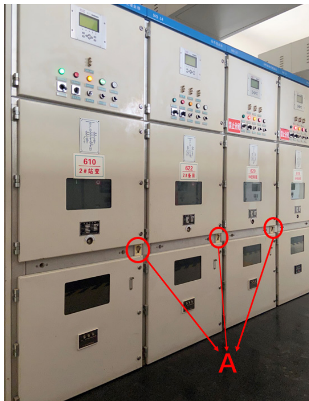
图1 接地开关操作机构的分合闸操作口
