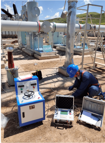
图1 变电站高压电气试验
