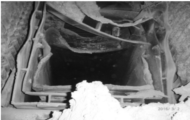
图6 燃烧器喷口磨损情况
