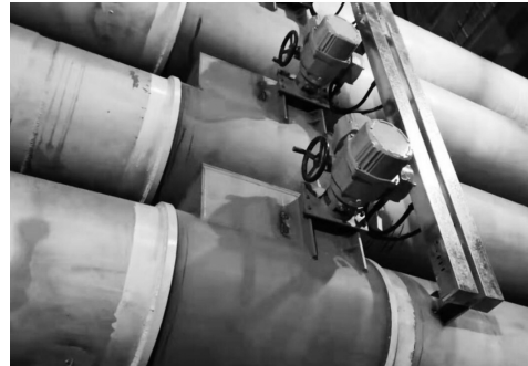
图 3 煤粉流速调节阀现场安装效果图
