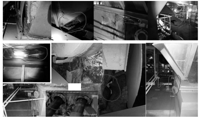
图7 锅炉漏风情况
