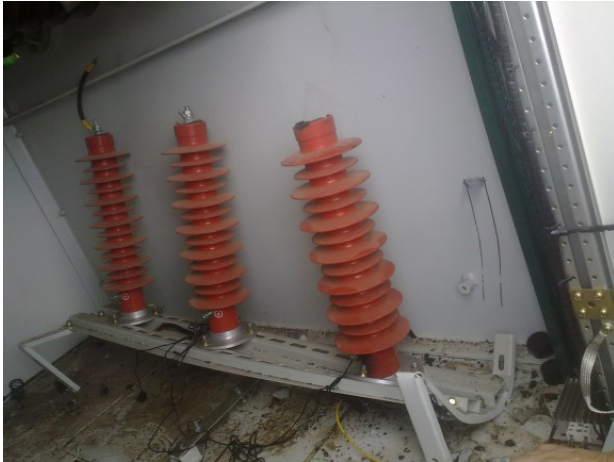
图 3 9 号箱变雷击故障后避雷器发生爆炸损坏
