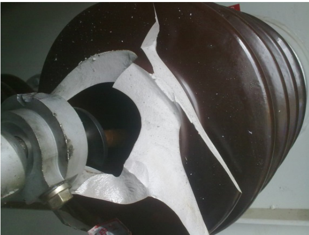
图 4 9 号箱变雷击故障后 C 相瓷瓶破损
