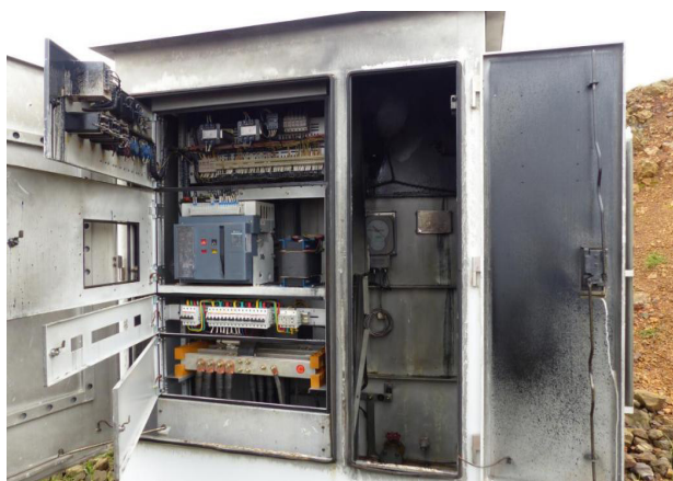
图 1 箱变低压侧配电柜内部烧毁严重
