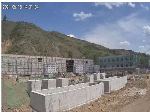
图11 110千伏升压站 SVG 基础监控
