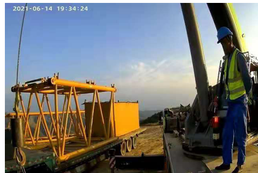
图8 现场作业人员违章站在作业吊车上
