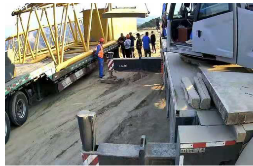
图7 现场多人未戴安全帽违章站在吊物下
