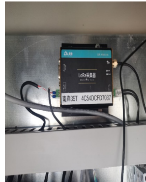
图14 LoRa4G 网关安装
