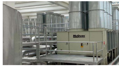
图 3 风冷热泵机组的导热风管
