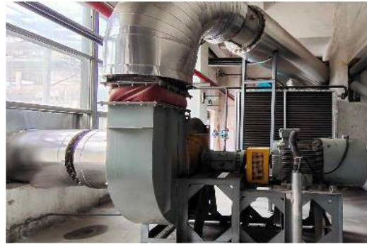
图 4 烟气再循环风机及烟道
