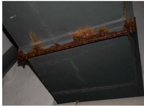
图11 烟道法兰连接处腐蚀
