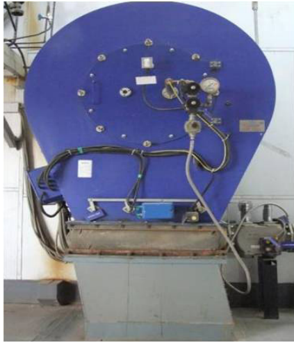
图 1 5# 锅炉燃烧器改造前
