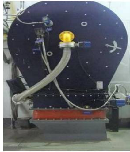
图 2 5# 锅炉燃烧器改造后
